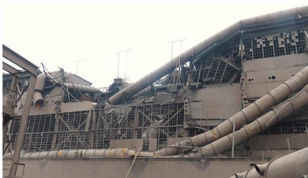
Рис. 1. Аварійне руйнування покриття будівлі конверторного цеху №042, блоку №1, заводу «АрселорМиттал Кривий Ріг»
