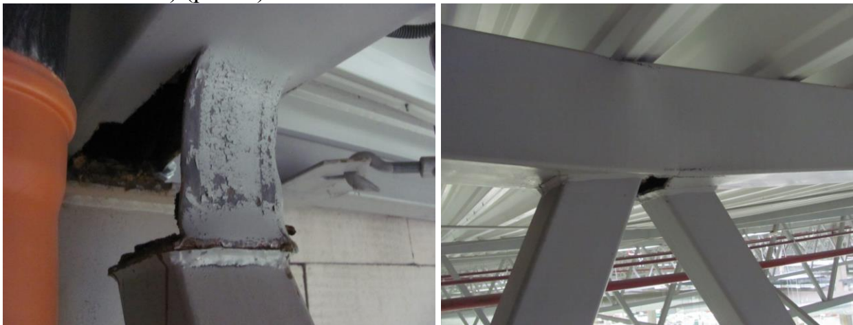
Рис. 1. Види пошкоджень і руйнування у сталевих фермах промислової будівлі
