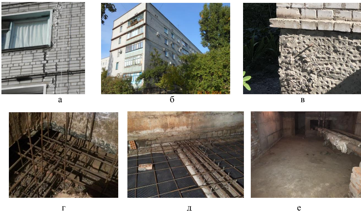
Рис. 1 Вигляд деформованої споруди та процесу посилення її фундаментів: а – вертикальні тріщини з шириною розкриття 15 мм; б – торцева блок-секція, посилена металевими тяжами; в – стінова осадочна марки на рівні цоколя; г – улаштування монолітних залізобетонних балок посилення; д – улаштування плити посилення; е – сучасний вигляд підвалу після завершення робіт
