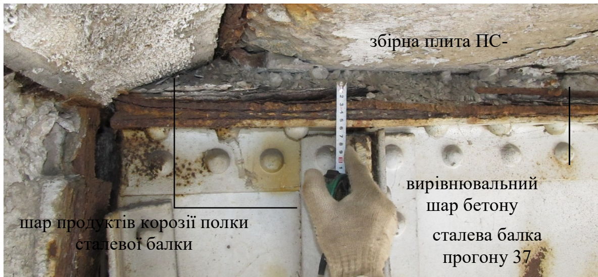
Рис.1. Стан опор низових збірних плит по вісі 36
