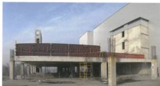
Рис.6. Випробування фрагменту перекриття другого поверху. Навантаження прикладається шляхом наповнення ємкостей водою. Вигляд збоку
