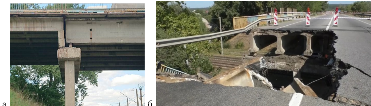
Рис. 2. Руйнування шляхопроводу: а – нахил підферменників; б – падіння п'яти балок крайнього прогону
