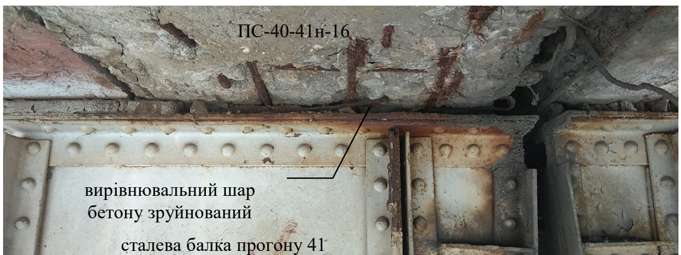
Рис.2. Стан опор низових збірних плит по вісі 41
