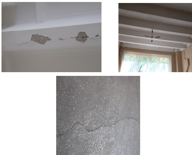
Рис. 2. Пошкодження несучих конструкцій каркасу будівлі
