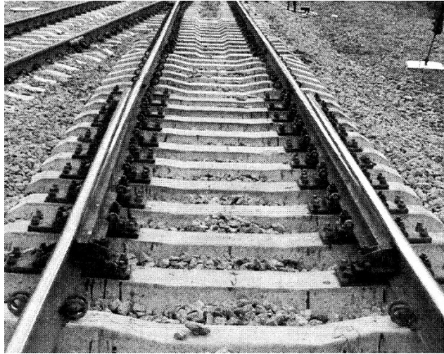
Рис. 4.17. Загальний вигляд зрівнювального приладу
