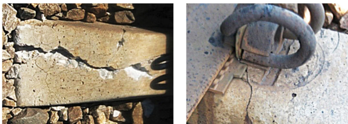
Рис. 2. Тріщини у залізобетонних шпалах: а – дрібна сітка тріщин від внутрішньої корозії і велика подовжня тріщина у кінці шпали; б – поперечна тріщина в зоні анкера
