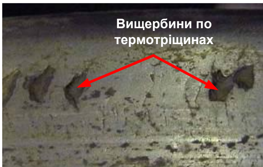
Рис. 4.66. Вищербини по термічних тріщинах на поверхні кочення обода колеса
