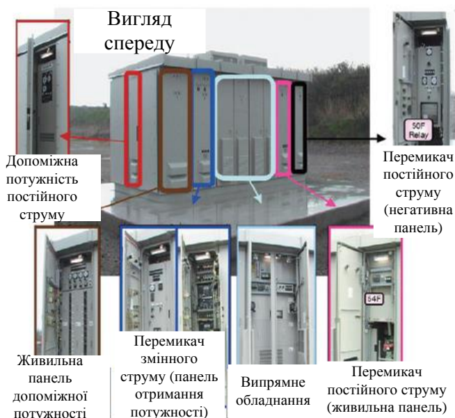
Рис. 23.2. Приклад тягової підстанції постійного струму комплектно-блочного типу виробництва Toshiba
