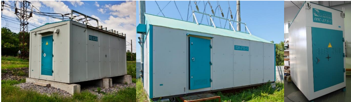
Рис. 4.7. Фото комплектно-блочних постів секціонування 3,3 кВ і 27,5 кВ та пункту паралельного з'єднання
