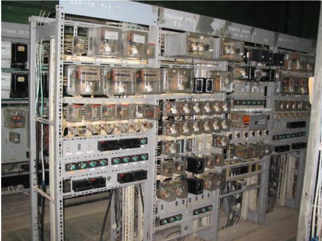
Рис. 22.2. Шафи релейного захисту та автоматики
