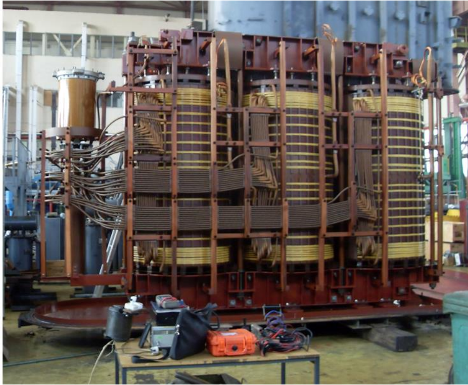
Рис. 5.4. Трансформатор ТДТН-40000/110 зі знятим колоколом
