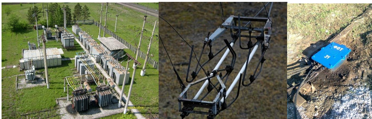
Рис. 2.2. Фото елементів схеми тягового електропостачання: тягової підстанції, нейтральної вставки та відсмоктувальної лінії (фідера зворотного струму)
