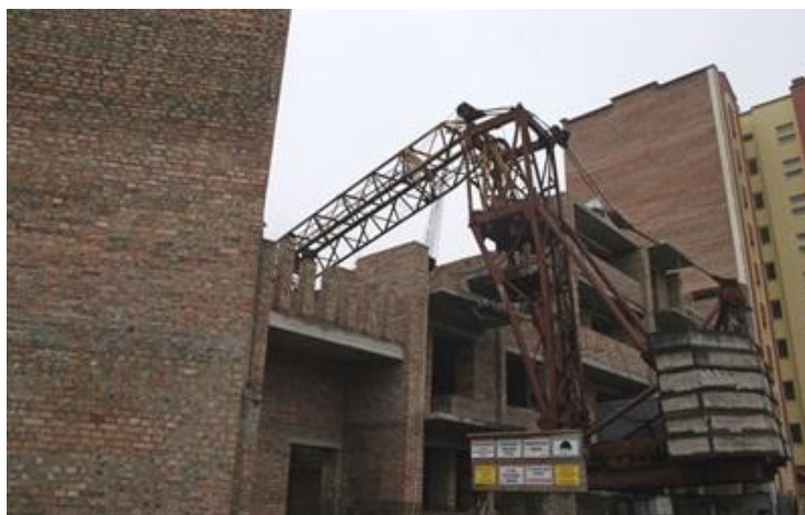
Рис. 1. Аварія баштового крана
