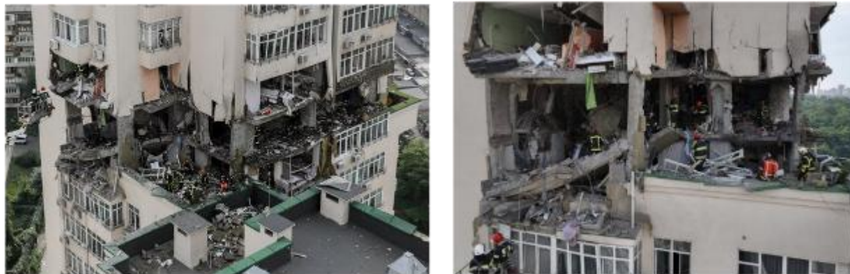
Рис. 1. Загальний вигляд пошкоджень та руйнувань конструкцій будівлі
