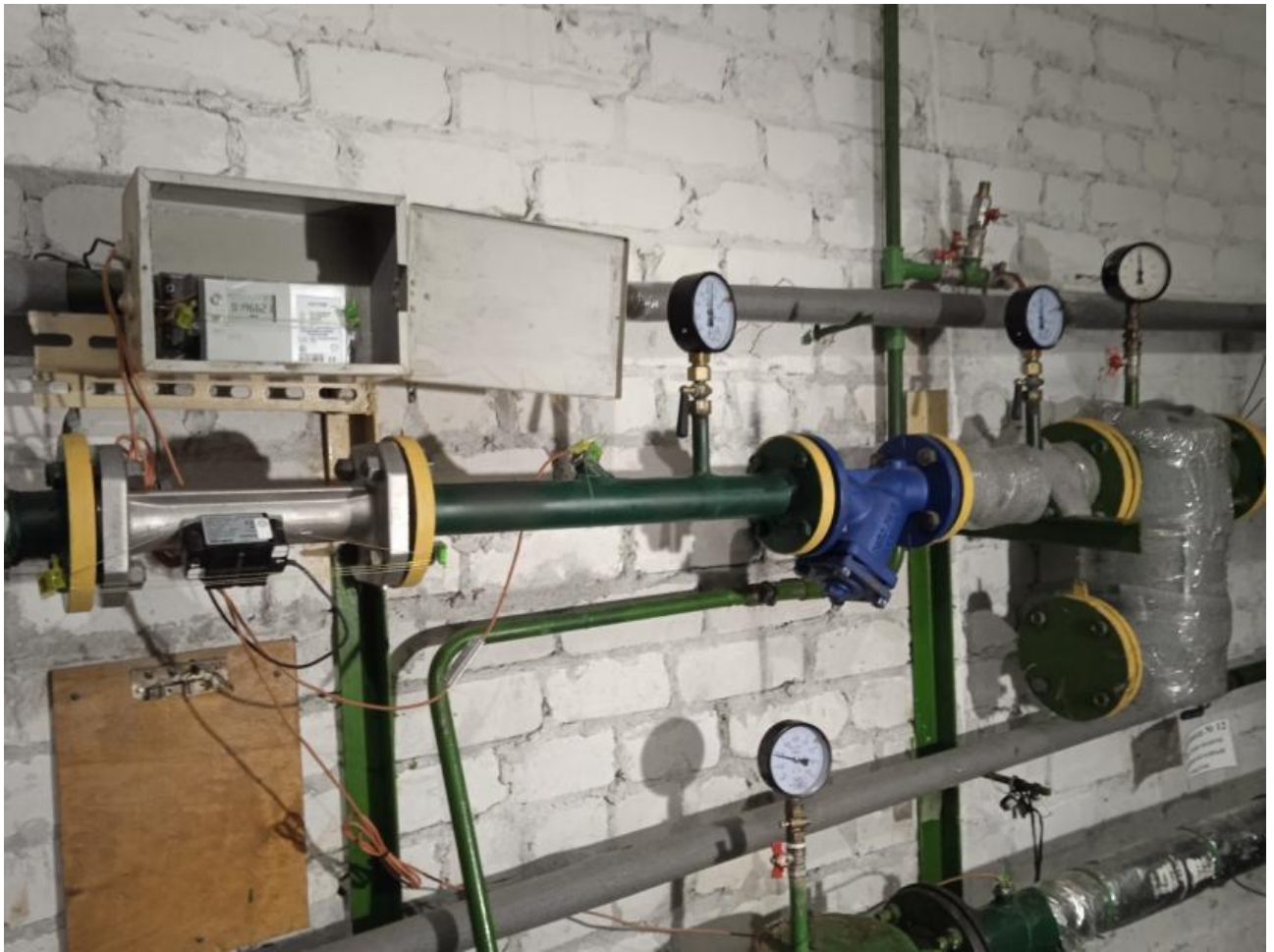
Рисунок 4.9 - Індивідуальний тепловий пункт
