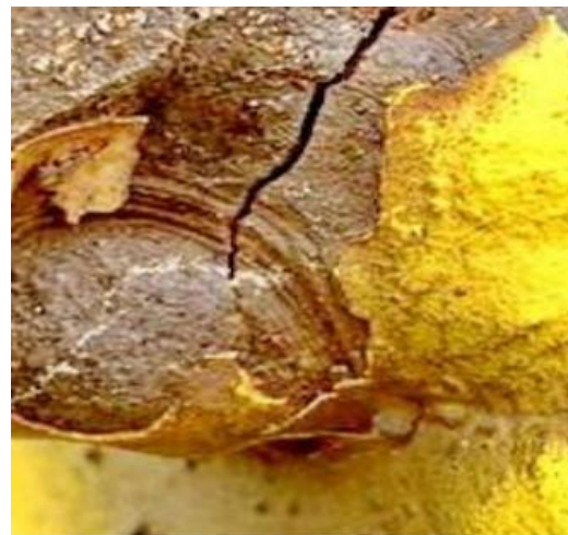
Рис. 2. Розвиток втоми тріщини в отворі для кріплення з'єднувального елемента стріли
