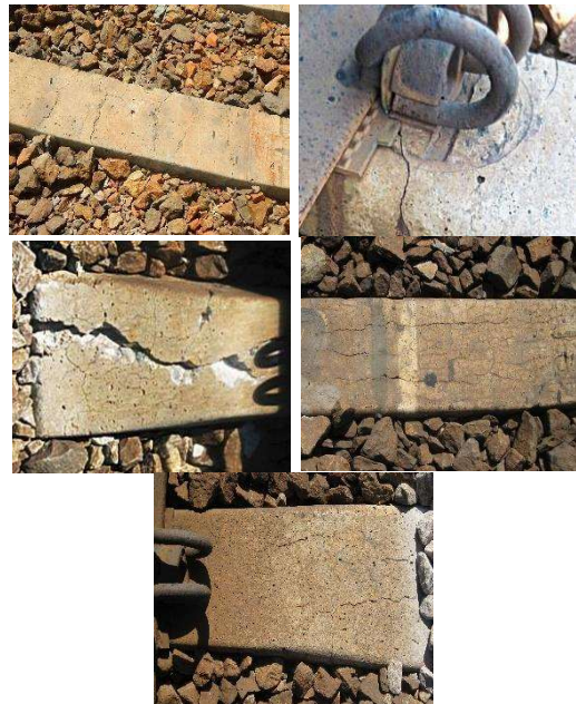
Рис. 1 Пошкодження (дефекти) шпал
