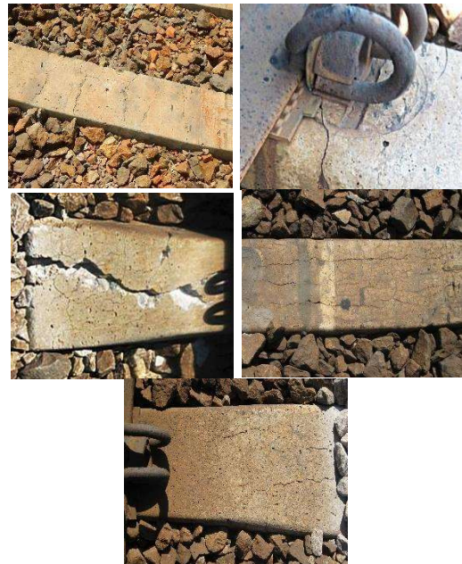
Рис. 1 Пошкодження (дефекти) шпал
