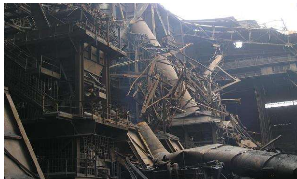
Рис. 2. Аварійний обвал ферм покриття у осях 8-12 (вигляд цеху в осях Г-Д)
