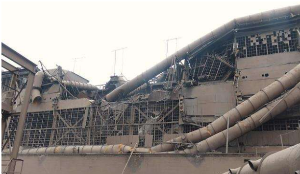
Рис. 1. Аварійне руйнування покриття будівлі конверторного цеху №042, блоку №1, заводу «АрселорМіттал Кривий Ріг»
