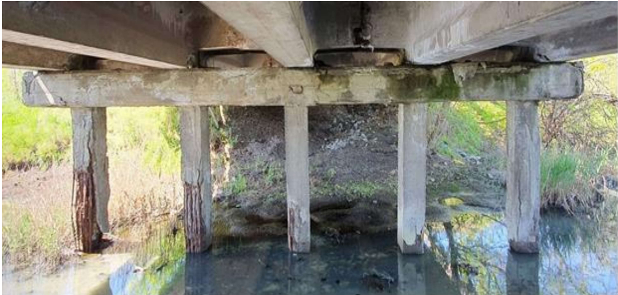
Рис. 1 Стан проміжної пальової опори автомобільного мосту через р. Бесарабівка в м. Слов'янськ
