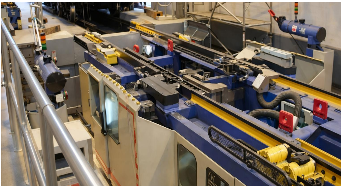
Рис. 1.5. Виробнича дільниця з технологічним обладнанням у вагоноремонтній майстерні для виконання TOP
