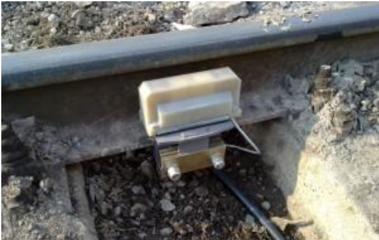
Рис. 13.7. Фото встановлення точкового датчика системи лічення осей на рейці
