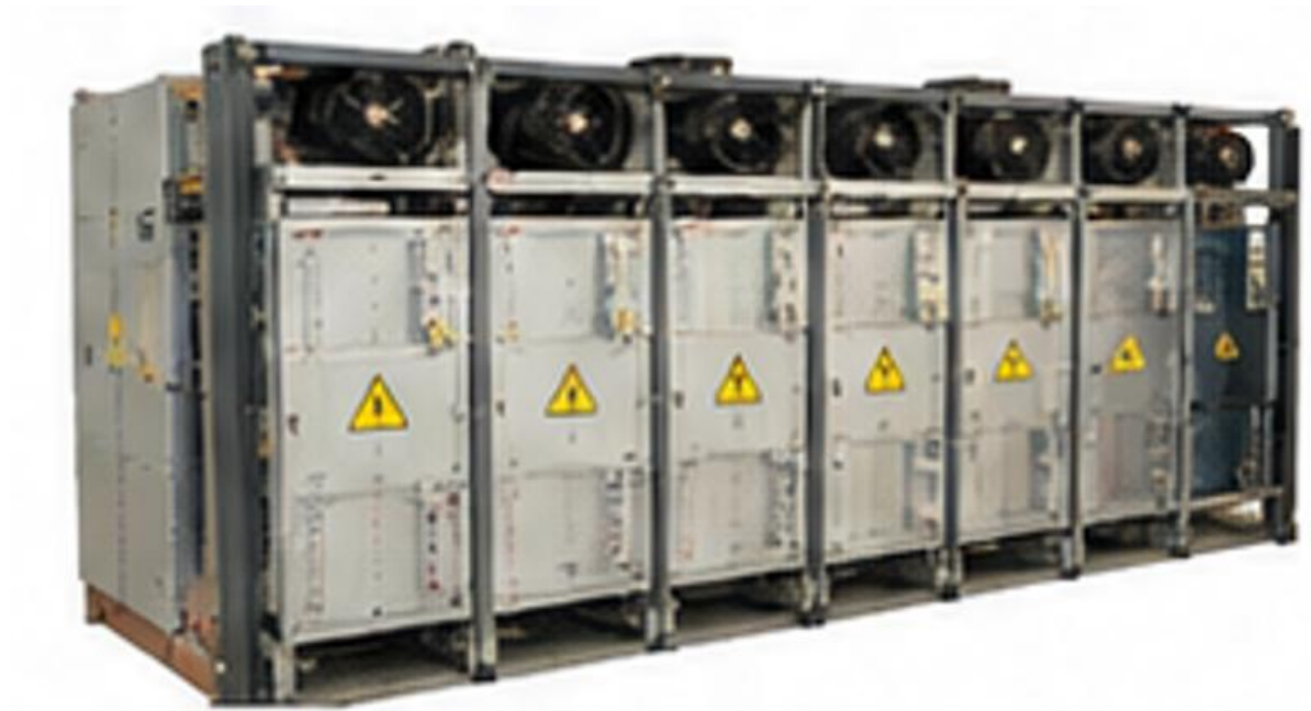
Рисунок 2 – Випрямна установка тягової підстанції
