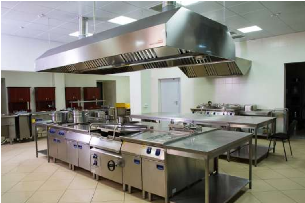
Рисунок 3.1 – Обладнання для кондитерського цеху
