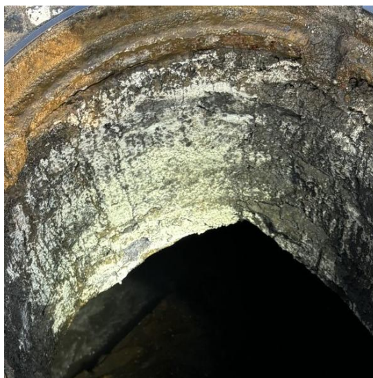
Рис. 3. Характерні ознаки біогенної корозії бетонної конструкції під час апробації алгоритму
