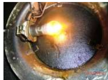
Рис. 1. Незадовільна якість ремонту пасажирських вагонів: а – холодні скрутки в електрощиті; б – протікання мастила з компресора вакуумного туалету на світильник у тамбурі
