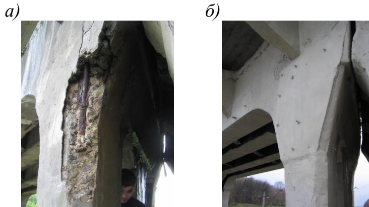
Рис. 32. Залізобетонний шляхопровід на 802 км ділянки Гребінка – Черкаси Південної залізниці: а) зруйнована частина залізобетонного стояка; б) посилення і захист від електрокорозії стояка за допомогою металоін'єкційної обшивки
