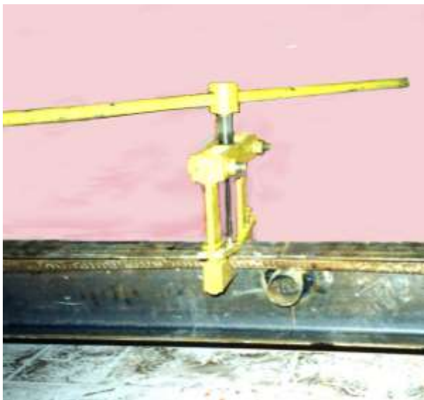
Рис.2. Локальное предварительное напряжение стальной балки до монтажа непосредственно на объекте (в перевернутом положении)
