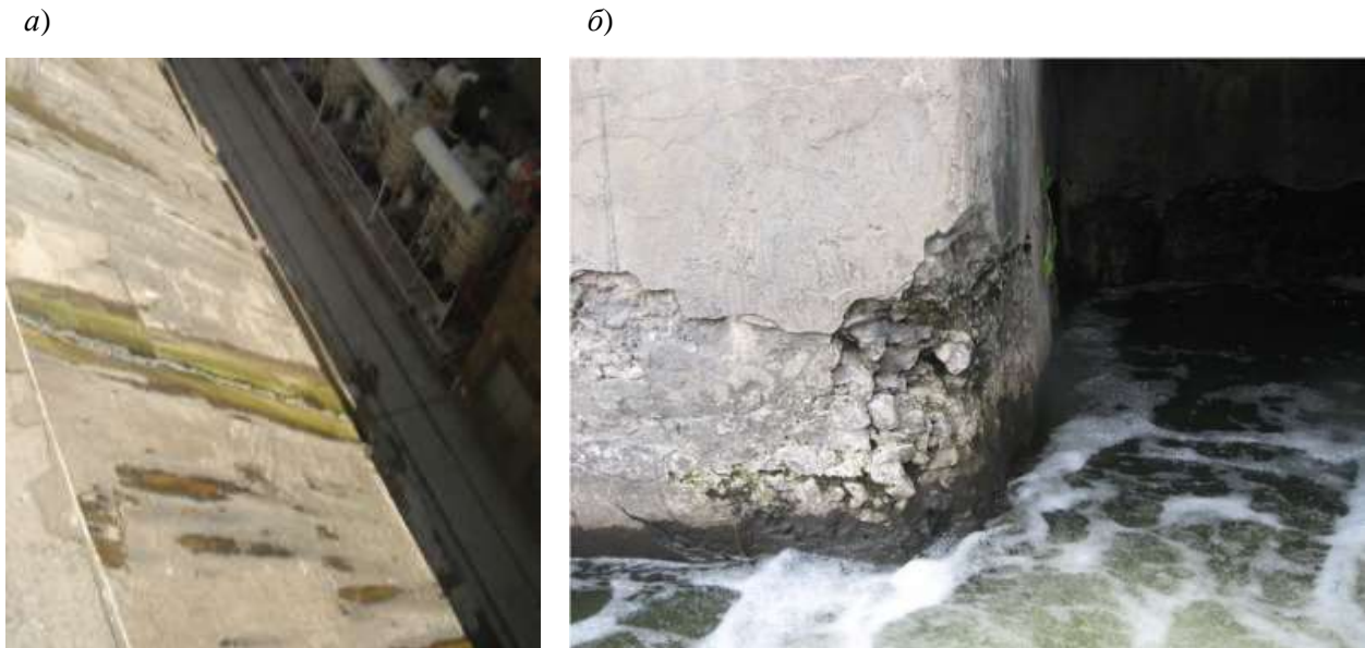
Рис. 1. Характерные повреждения напорных граней бетонных плотин: а – разрушение деформационного шва на напорной грани аванкамеры ДнепроГЭС (2012); б – разрушение поверхностного слоя бетона в зоне переменного уровня на быке левобережного устья Лопанской плотины (2013)
